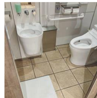
写真③ 汚物流しが設置された個室
