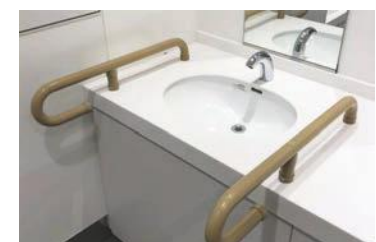
写真② 洗面台の手すり
