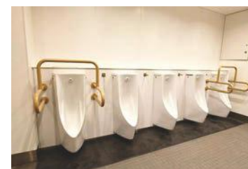
写真① 小便器の手すり
