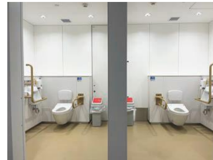
写真 左右対称に設備が設置された個室
