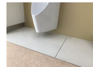
写真② 下端を空けて清掃しやすい工夫がされた小便器
